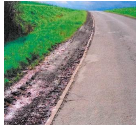
Ein typischer Schaden, verursacht nicht durch einen PKW. (Quelle: Bauamt SG Rodenberg, Levin)
